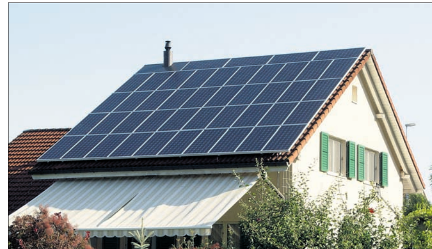
Photovoltaik Anlage mit einer Leistung von 8.8 kW.
