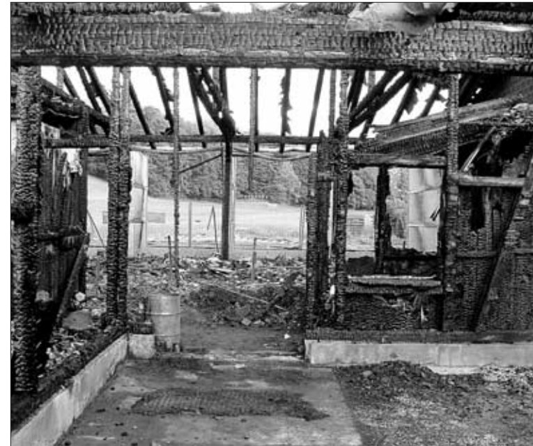
Am Tag darnach, Blick durch das verbrannte Schützenhaus.
