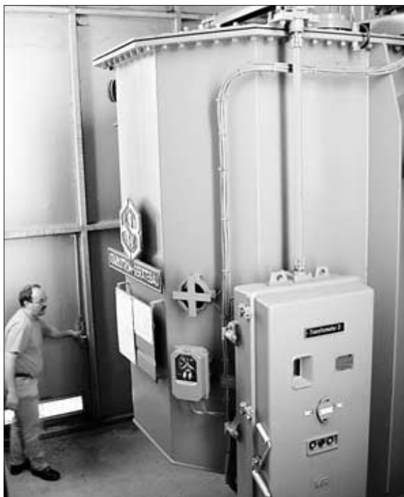
Der vorderste Teil des ersten Transformators.
