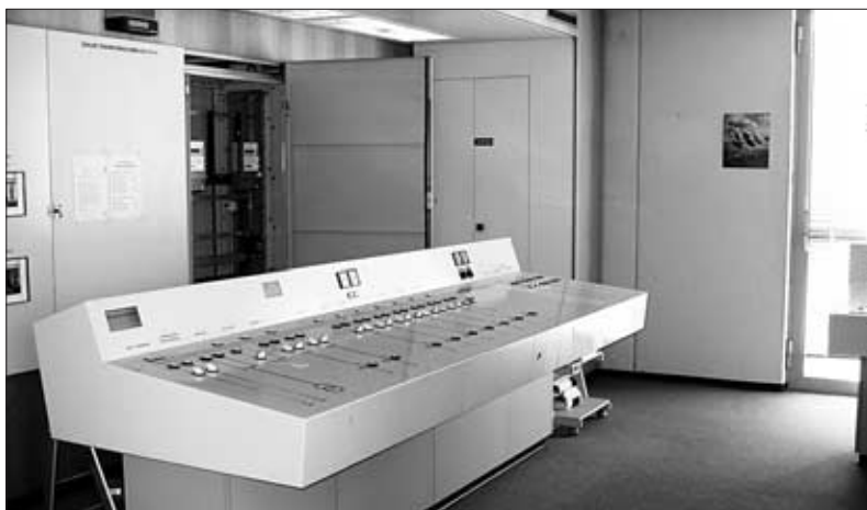
Das «Stellwerk» im Kommandoraum der Unterstation.
