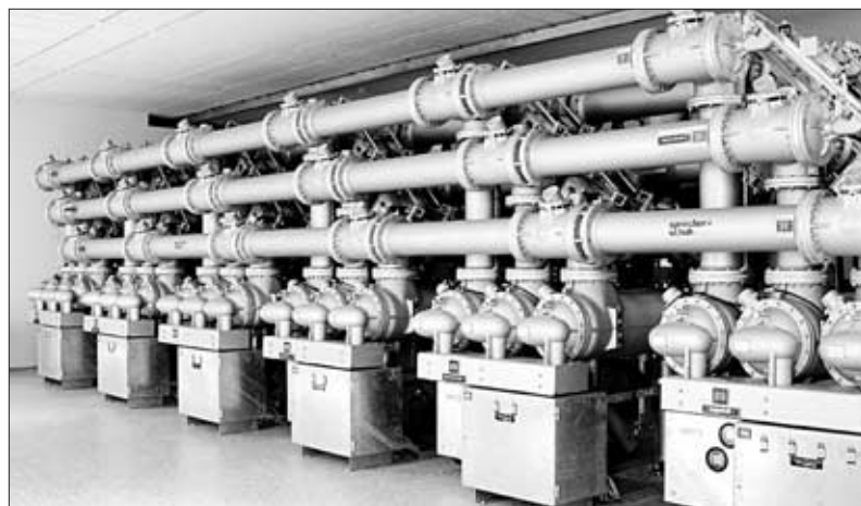
Die Schaltanlage im 1. Stock für die 132kV-Leitungen.
