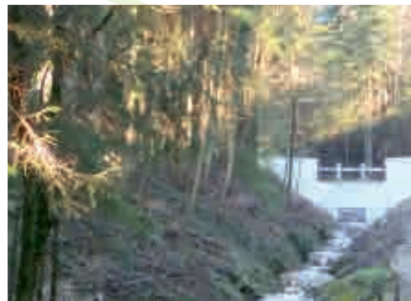
Rückhaltewand für Geschiebe.
