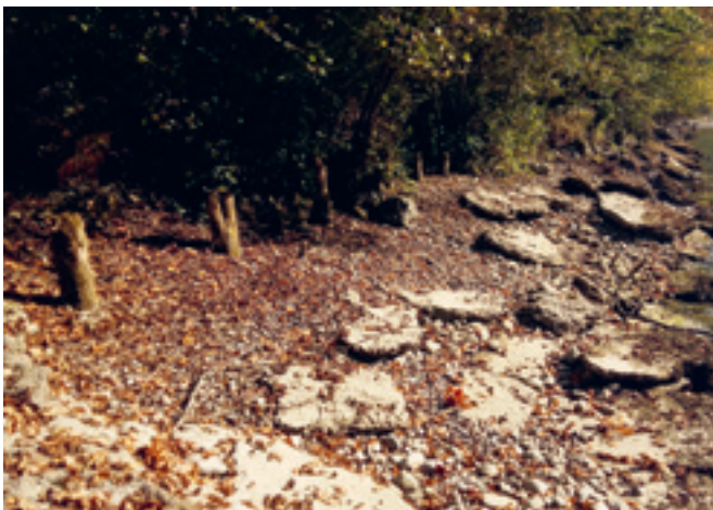
Zerstörter, etwa 50 jähriger Längsverbau
