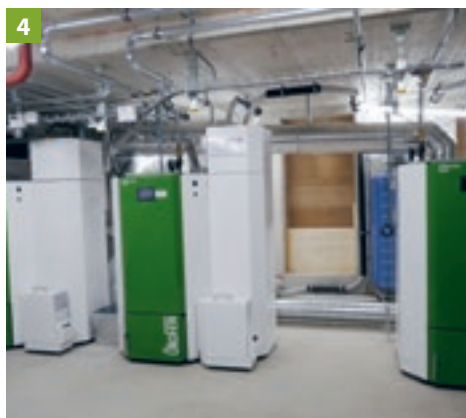
Heizzentrale mit Öfen
