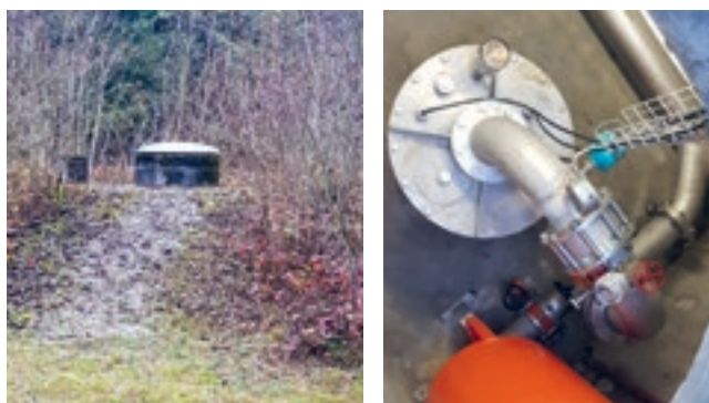
Grundwasserfassung Mälchplatz (rechts: Ansicht von oben).
