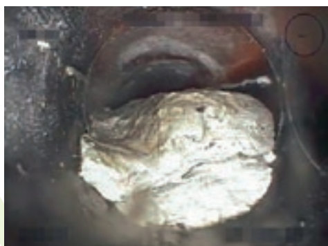
ZpA - Rohr mit Verstopfung.
