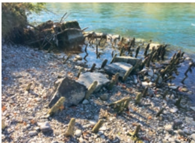
Heute: Schutzbauten sind weggeschwemmt
